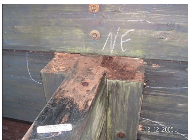
Abb. 3: Fäulnis im Verbindungsbereich Randbalken mit mehrteiliger Stütze
