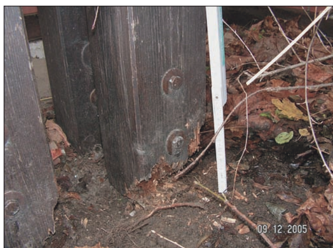
Abb. 4: Stützenfüße mit Fäulnis infolge Erdkontakt und Belastung durch Spritzwasser
