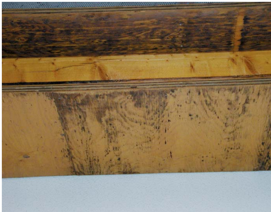
Bild 1: Schimmel- und Bläuepilze an Dachüberständen und anderen Außenbauteilen aus Holzwerkstoffen sind ein aktuelles und bekanntes Problem.
