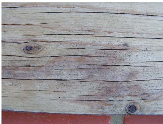
Bild 2: Holzverfärbende Pilze auf einer kesseldruckimprägnierten Platte im Außenbereich
