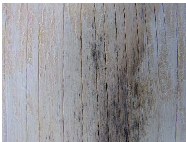
Bild 3: Schälrisse und Pilzbefall auf der Oberfläche einer Nadelsperrholzplatte nach freier Bewitterung
