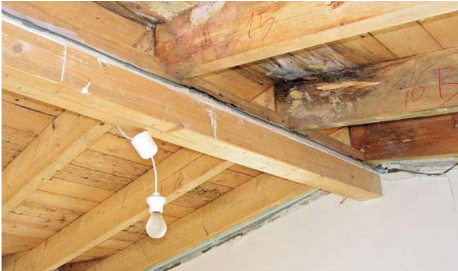
◀ Abbildung 8: Fäulnis an Sparren in einem beidseitig geschlossenem Dachaufbau
