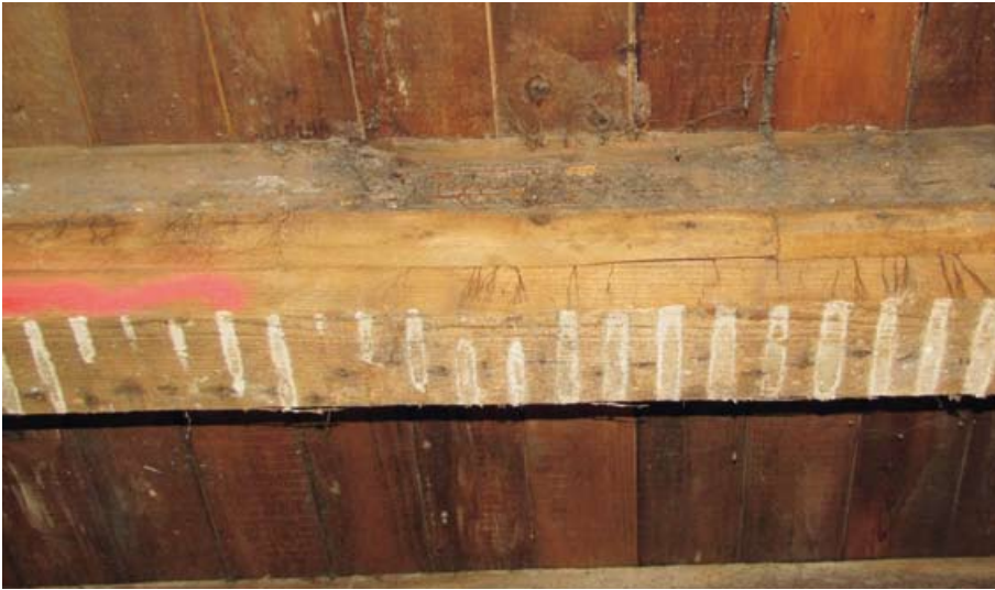
◀ Abbildung 13: Deckenbalken mit leichter seitlicher Fäulnis und altem Myzel (Brauner Keller- schwamm) in Raummitte (Wohnbereich, GK0). Der Balken kann ohne Maß- nahmen erhalten bleiben
