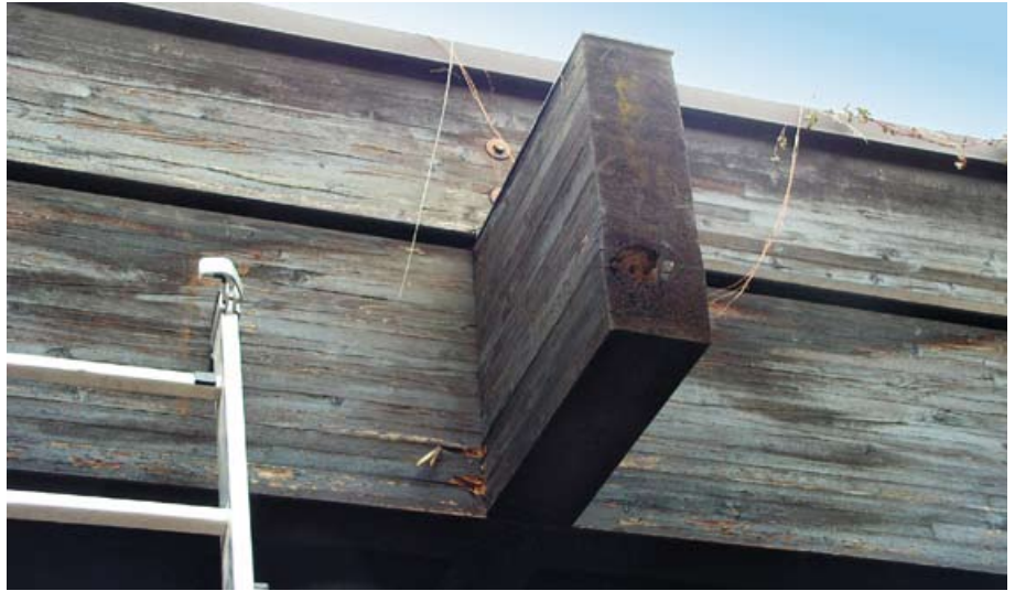
► Abbildung 12: Oberseitig abgedecktes Brettschichtholz mit Fäulnissschaden
