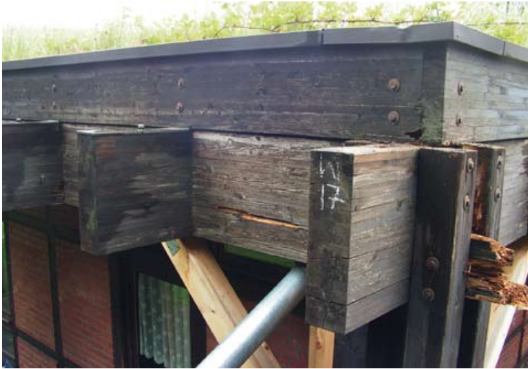
► Abbildung 5: Fäulnis unter einer gestrichenen Holzoberfläche
