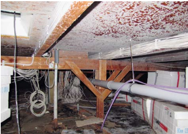
▼ Abbildung 2: Schimmelpilze an der Unterseite einer Dachkonstruktion
